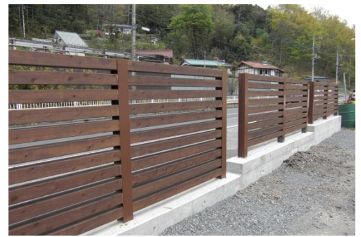
●モデルフェンスの設置状況
